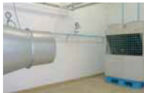
Test di ermeticità all'acqua Verifica se il quadro elettrico sia effettivamente ermetico.
