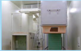
اختبار تدفق الهواء Airflow testing
